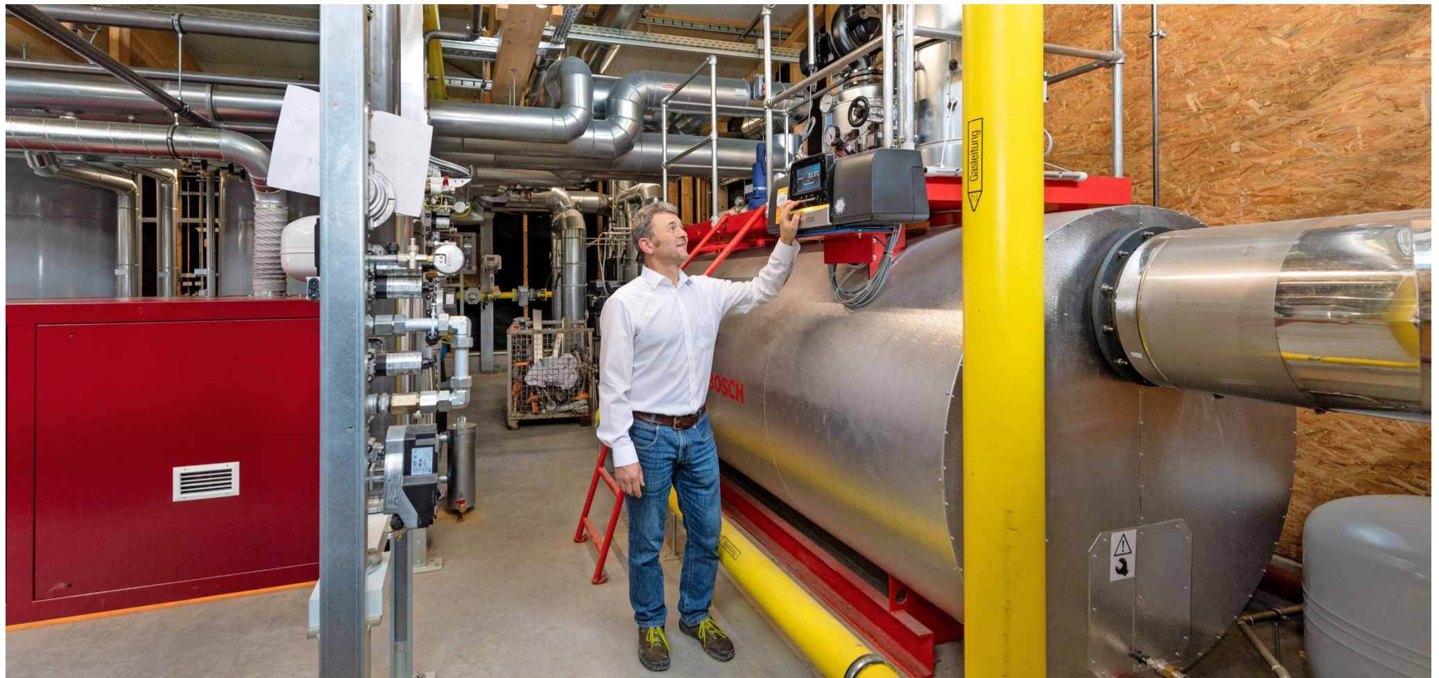
Ein Gewirr aus Rohren und Leitungen: Thomas Gessler von der Gemeinde an einem der Blockheizkraftwerke in der Abwasserheizzentrale in Ilsfeld.
