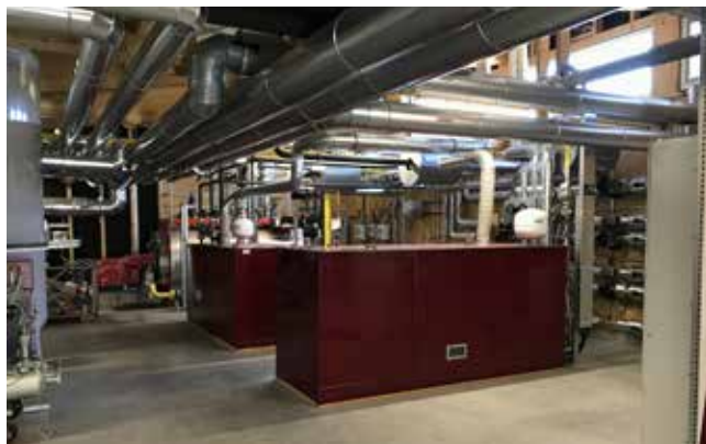
Abb. 2: Wärmepumpenzentrale mit BHKW und dem 1800 kW Gas-Spitzenlast und Reservekessel
