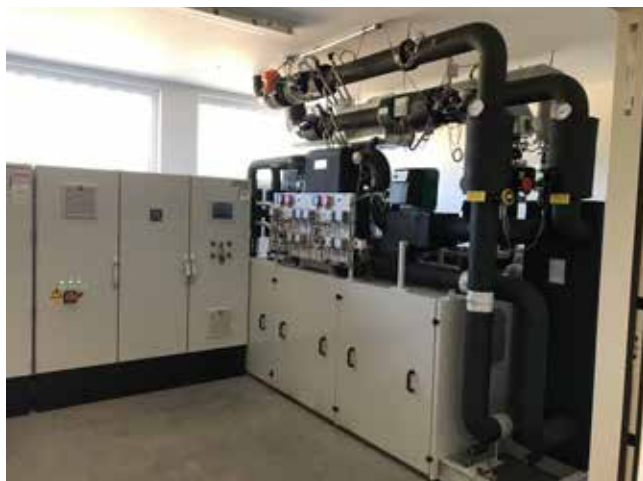
Abb. 3: Wärmepumpe (Fabrikat Combitherm)
