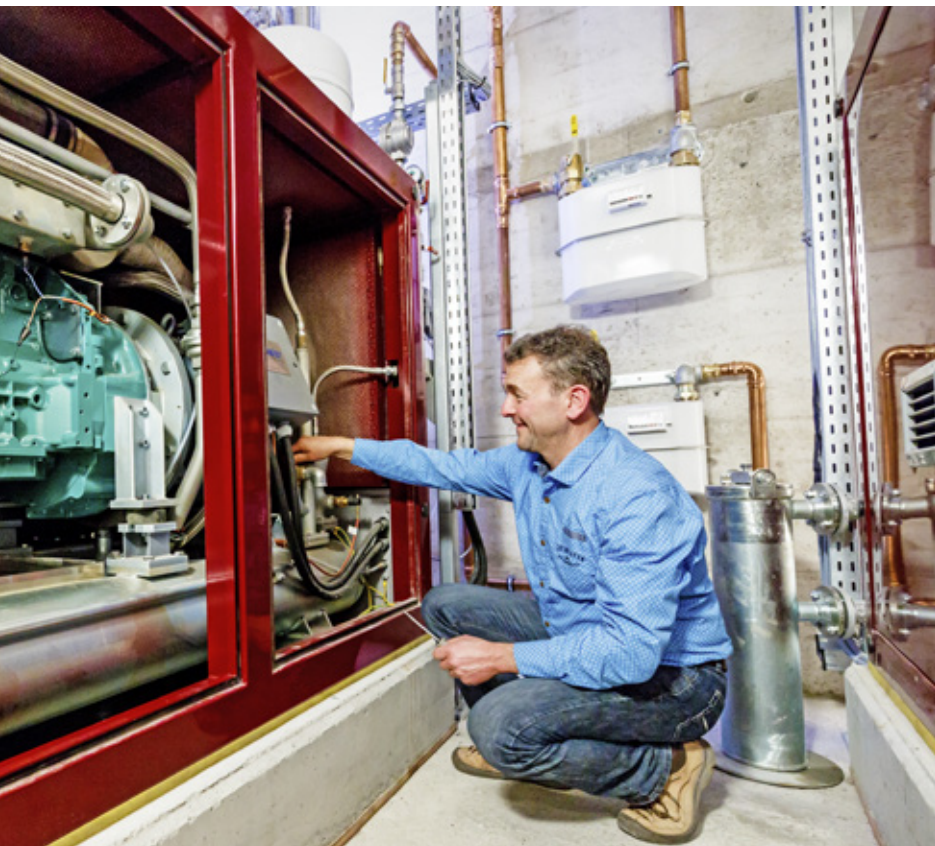
Nahwärme Bis Ende 2018 sollen 700 Einwohner an das Netz angeschlossen sein
