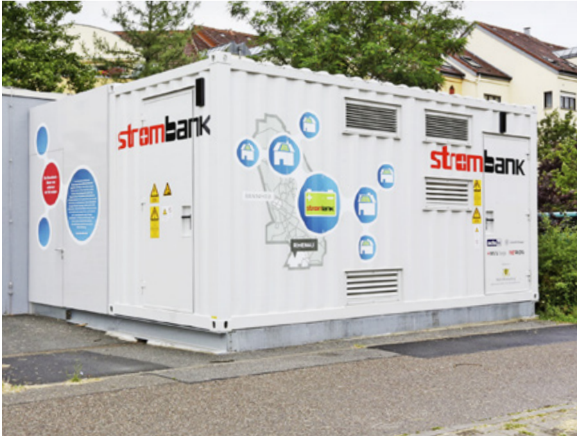
Bankfiliale In diesem Container wird der Ökostrom gespeichert
