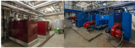
Erdgas-BHKW + Wärmespeicher + Gas/Öl-Kessel
