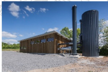
Wärmepumpen + Erdgas-BHKW + Wärmespeicher
